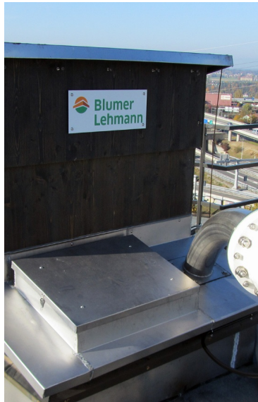
Streugut-Siloanlage mit Streufahrzeuge in Bern Wankdorf
